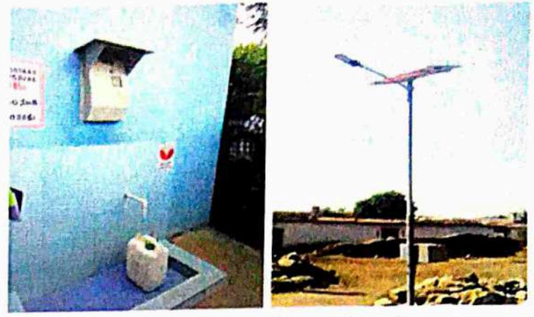
चित्र 6: एनी टाइम वाटर मशीन तथा सोलर स्ट्रीट लाइट
